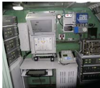
Автоматизированное рабочее место электромеханика электростанции
