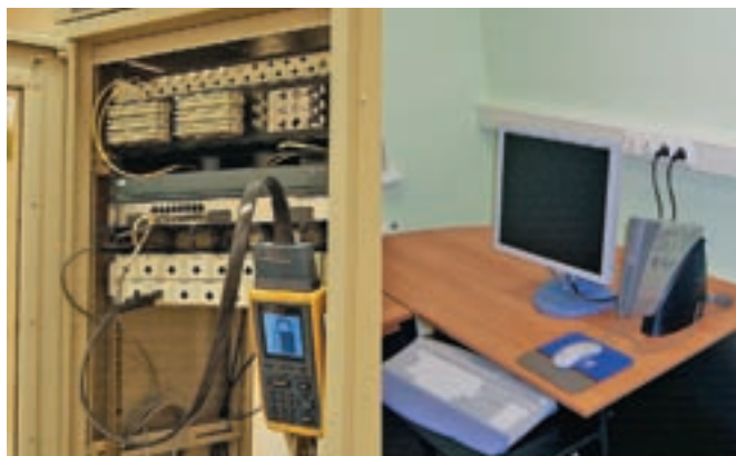
Работа по оснащению Единого Центра Данных на базе НИЦ ГНИНГИ Минобороны России. Тестирование коммутационного оборудования (слева), рабочее место оператора на базе консоли Sun Ray
